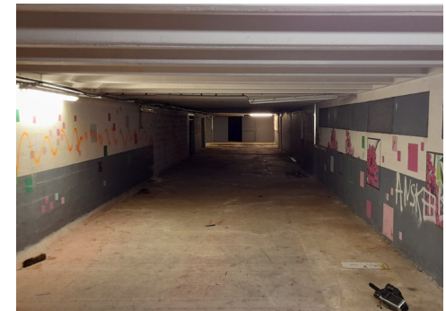
Premier sous-sol du parking, aujourd'hui condamné
